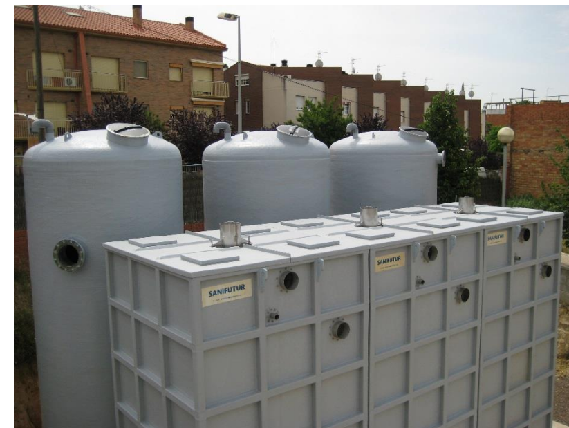
Imatge 10. Infraestructures de l'ETAP de Molins de Rei
