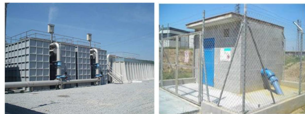
Imatge 271. Planta potabilitzadora de Sant Vicenç dels Horts i pou d'extracció d'aigua freàtica
